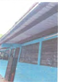
CANALES PLUVIALES, SUSTITUCION DE CANALES PLUVIALES, EN MAL ESTADO SIN PENDIENTE
